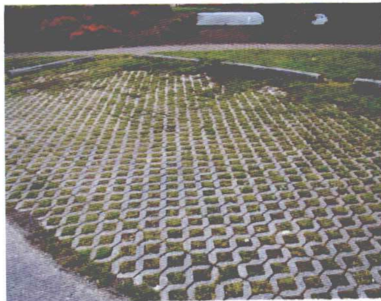
FIGURA 15- 8: PAVIMENTO PERMEÁVEL EM ESTACIONAMENTO
