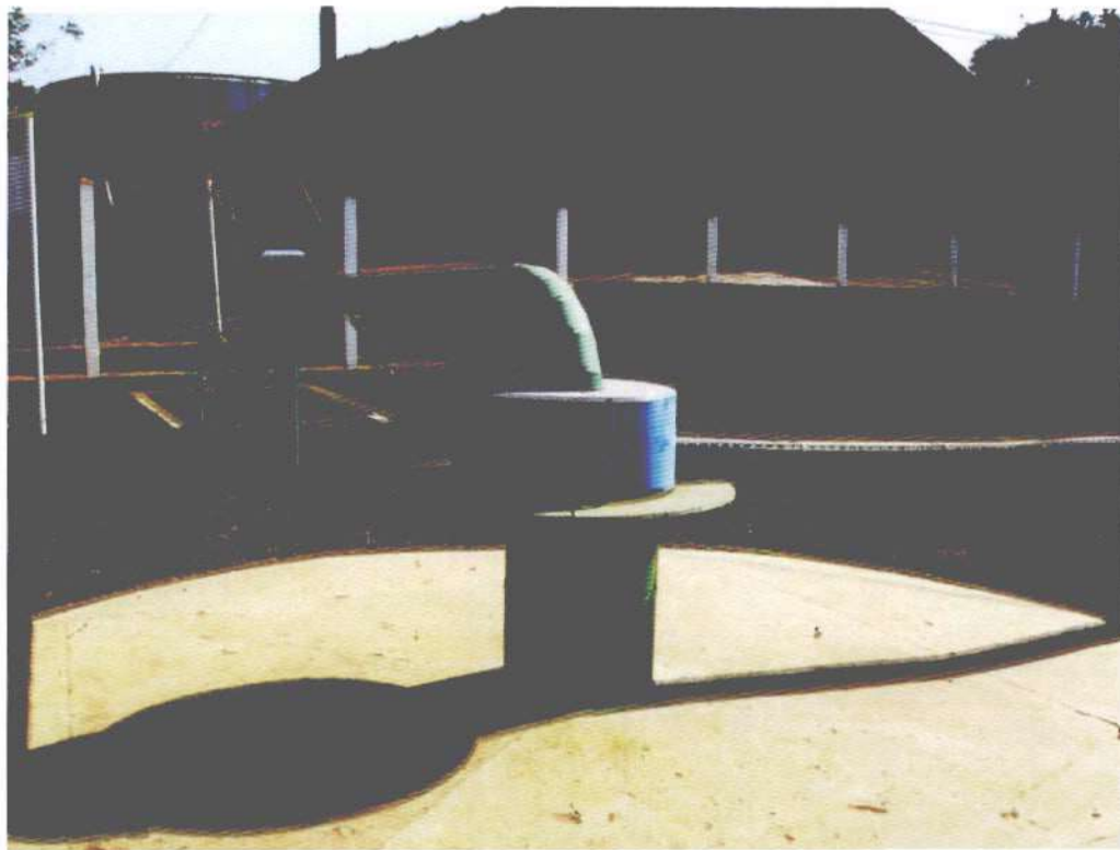
FIGURA 5- 7: BARRILETE DE SAÍDA DO POÇO P01
