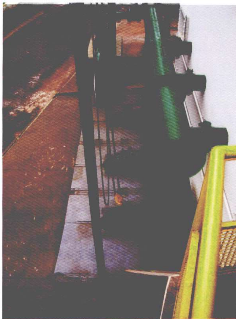
FIGURA 5- 3: FOTO DO TANQUE DE SUÇÃO DAS BOMBAS DA CAPTAÇÃO SUPERFICIAL
